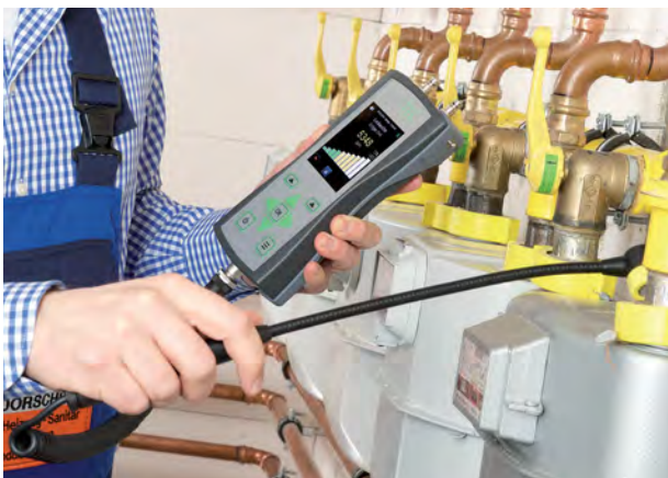
Gaslecksuche mit Erdgassensor
