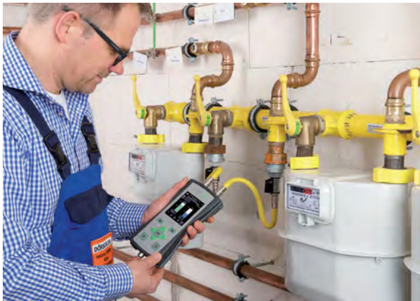
Leckmengenmessung bei demontiertem Zähler
